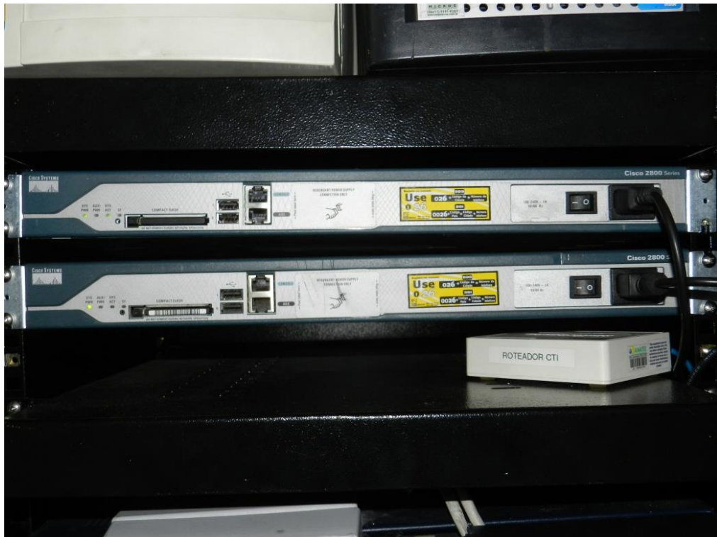
Vista de roteadores.
