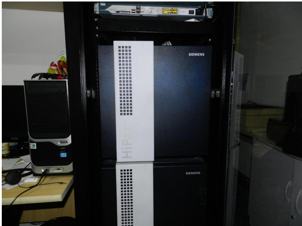
Vista do PABX analógico-digital - Siemens/ HiPath 3000.
