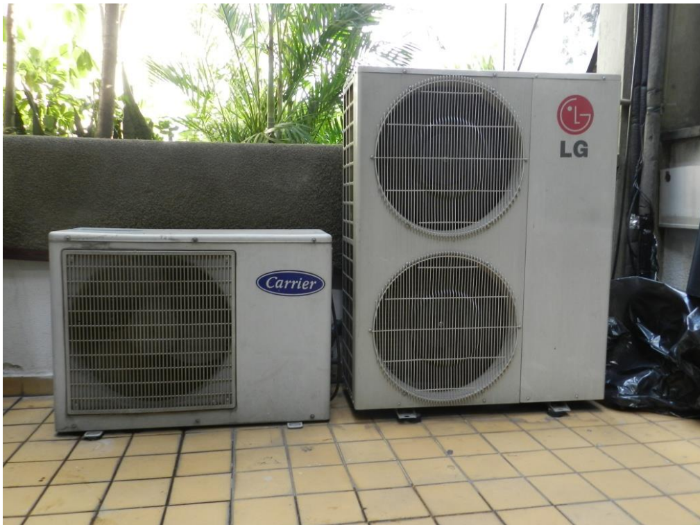
Vista do sistema de Ar-Condicionado.
